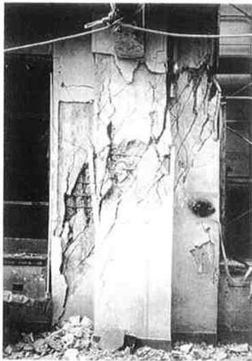
図3.3.5 1 通り柱の最終破壊状況
